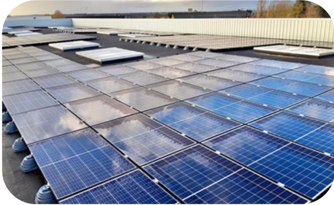
PV en toiture
