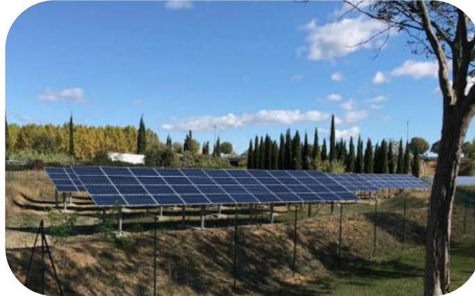
PV au sol
