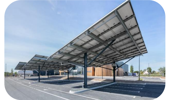
PV en ombrières
